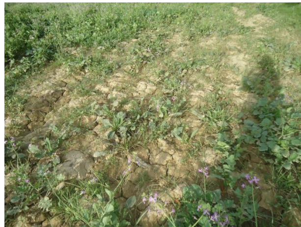
Figura 27. Formación de grietas en Valenzuela 4G sud
